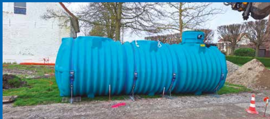
Armbouts-Cappel, rue Paul Libbrecht. Noues et cuves de stockage des eaux pluviales
